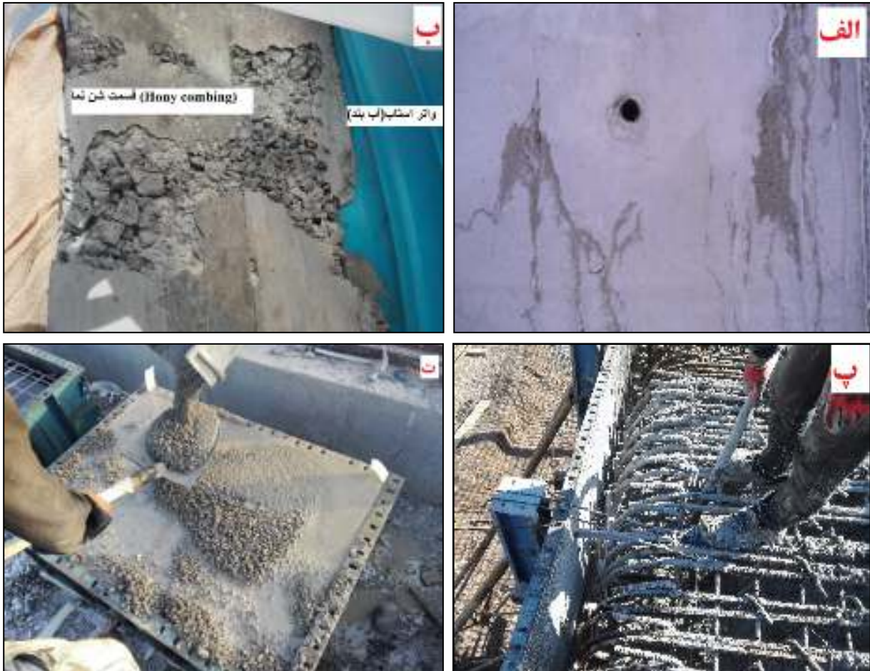
شکل ۶- نمایی از اثر قالب‌زدگی سطحی (الف) و کرموشدگی (Hony combing) شکل (ب)، شلوغی و تراکم میلگرد در آبروهای این پروژه (پ)، جداشدگی و آب‌انداختگی بتن در اثر استفاده بیش از اندازه فوق‌روان‌کننده (ت)
