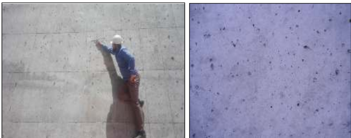
شکل ۴- تصاویری از وجود حباب در سطح بتن اجرا شده (سطح آبله رو)، در هر دو تصویر حباب‌ها دارای اشکال نامنظم هندسی هستند
