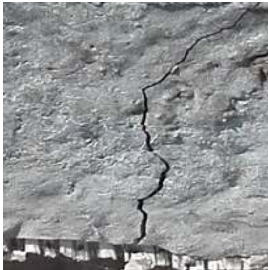
شکل ۷- ایجاد ترک خمشی در دال بتنی تقویت شده با ۱ لایه ورق GFRP
