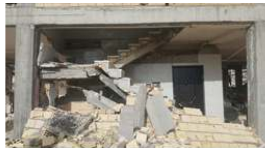
شکل (۱۸) - اثرات تخریبی متقابل دیوار و ستون
