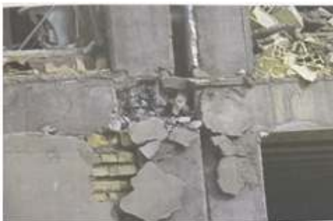
شکل (۲۶) - خرد شدن بتن در محل گره به علت ضعف مقاومت
