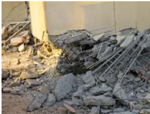
شکل (۱۱)- تخریب دیوار برشی در یک ساختمان مسکن مهر شهید شيرودی سرپل ذهاب
