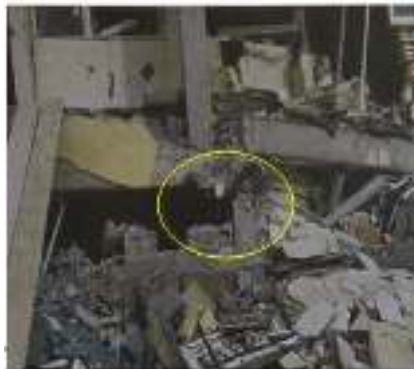
شکل (۲) - خرابی کلی در اثر ستون کوتاه
