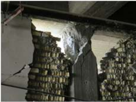
شکل (۱۶) - اثرات تخریبی متقابل دیوار و ستون
