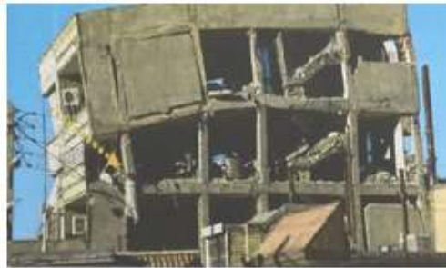
شکل (۲۰) - اثر تخریبی راه پله، پیچش، عدم اجرای وال پست، ستون ضعیف در سرپل ذهاب
