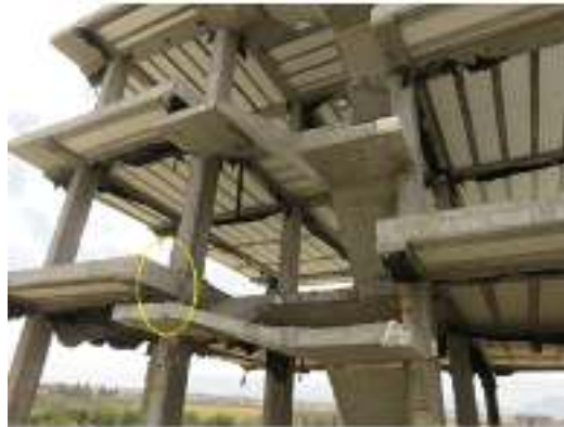
شکل (۲۴) - ایجاد ترک در تیر طره به علت نیروی قائم زلزله
