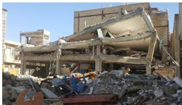
شکل (۹) - خرابی ساختمانی در سرپل ذهاب در اثر ترکیبی از ضعف های فنی از جمله طبقه نرم، طبقه ضعیف و ستون ضعیف - تیر قوی
