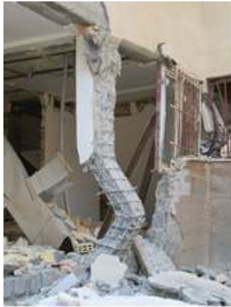
شکل (۶)-ضعف مقاومت ستون در طبقه همکف مسکن مهر در اسلام آبادغرب
