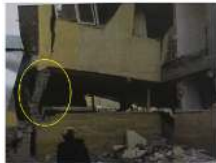
شکل (۳) - ایجاد ستون کوتاه به علت وجود دیوار
