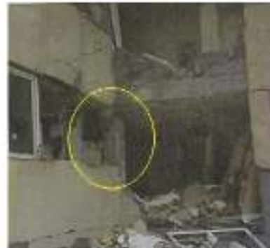
شکل (۱) - ایجاد ستون کوتاه به دلیل دیوار کوتاه میانقاب
